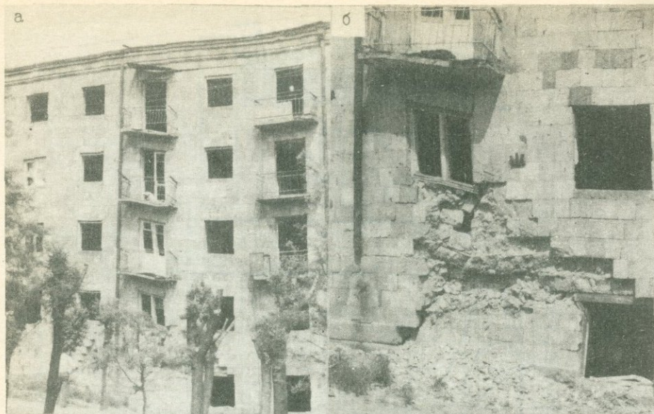
Рис.141. Разрушение жилого дома (г.Ереван) вследствие больших просадочных деформаций структурно-неустойчивого грунта («белозема») основания фундамента.
