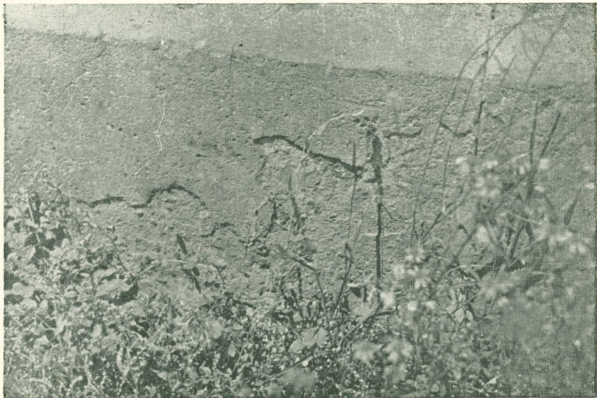
Фиг. 62. Церковь Рипсимэ, 618 г. Образование корки на цоколе и отслаивание ее.
