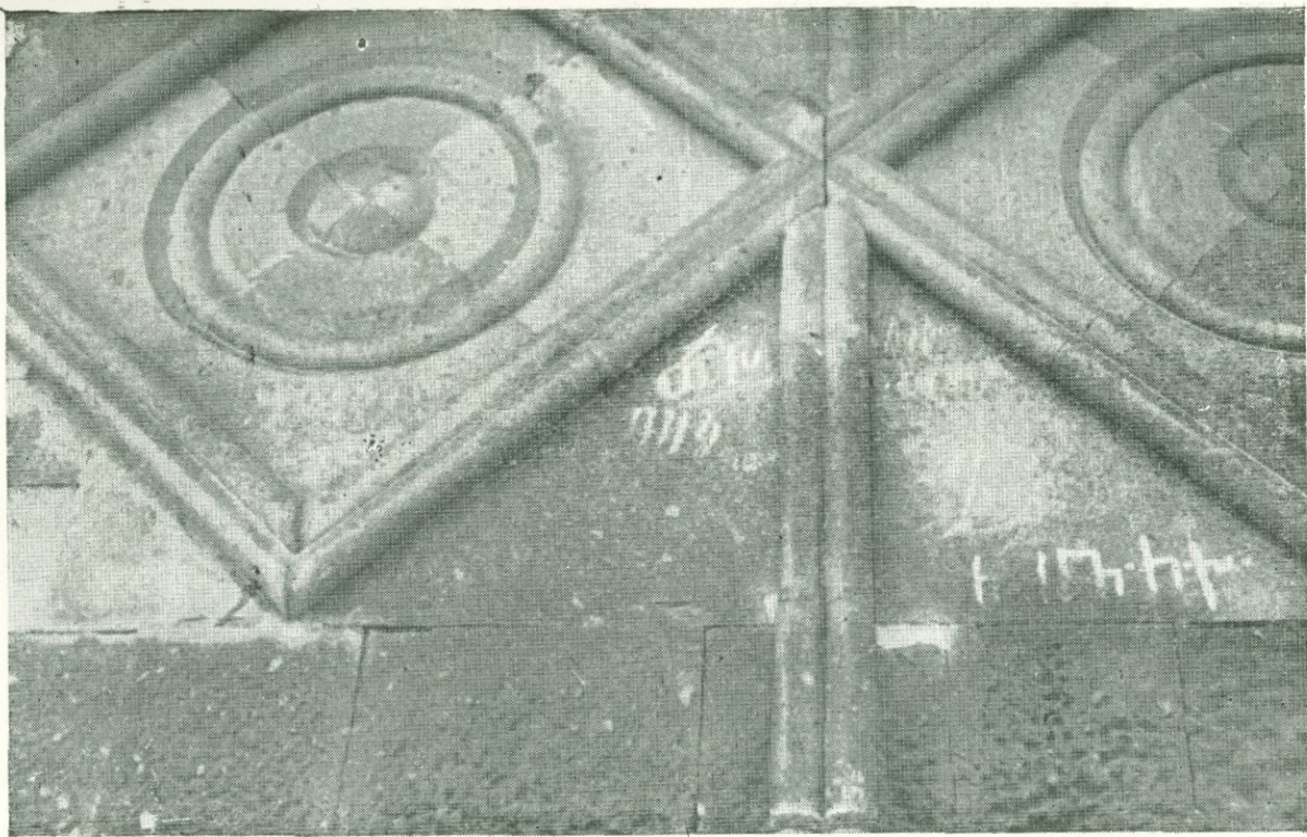
Фиг. 71. Ованнаванк. Восточный фасад церкви, 1217 г. Выветривание нижнего ряда камней.
