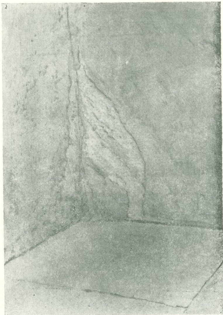
Фиг. 48. Жилой дом Гушосдора по ул. Барекамуган, 1944—45 гг. Отслаивание туманянского туфа.
