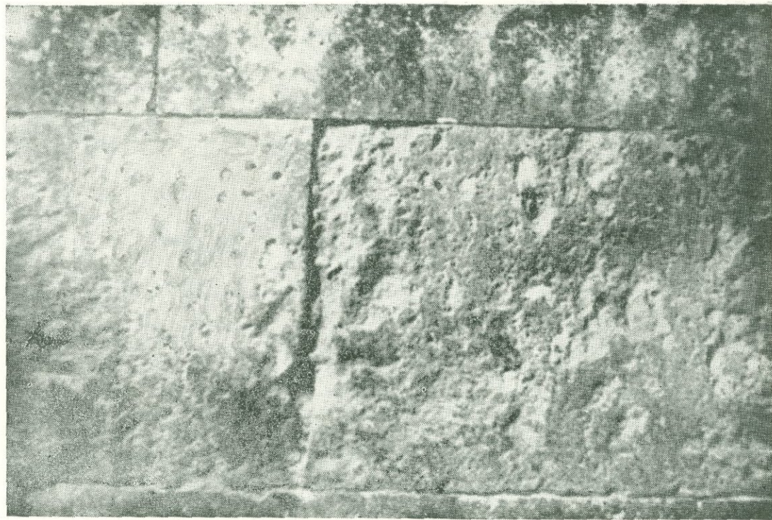
Фиг. 93 Церковь Аменаркич в г. Ленинакане, 1859–1873 гг. Выветрившиеся камни во втором ряду покая на южном фасаде.
