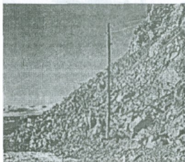
Рис. 3.19. Оползание туфовых пород около Спитака [134].
