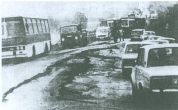
Рис. 18. Трещины, образованные в проезжей части дорог [4].
