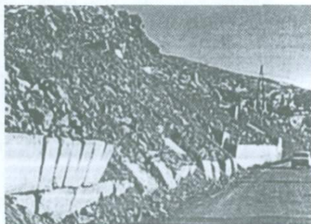
Рис. 15. Обвалы железобетонных подпорных стен около Спитака [1].
